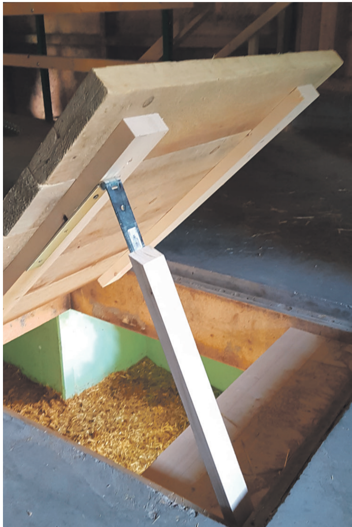
Grundsätzlich sollen alle Bodenöffnungen mit einem angebänderten Deckel verschlossen sein. (Bild: BUL)
