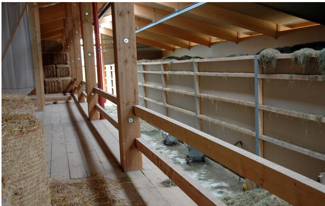
Stabiles Geländer auf einem Lagerboden mit Brustwehr und Knieleiste
