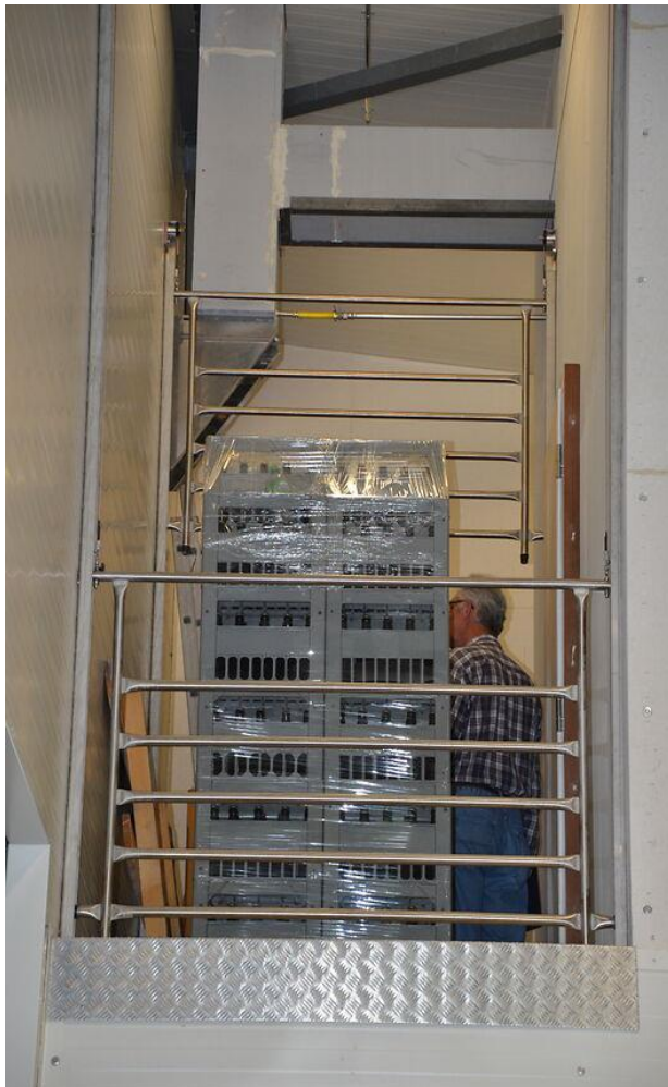
Warenschleuse im Pendelsystem
