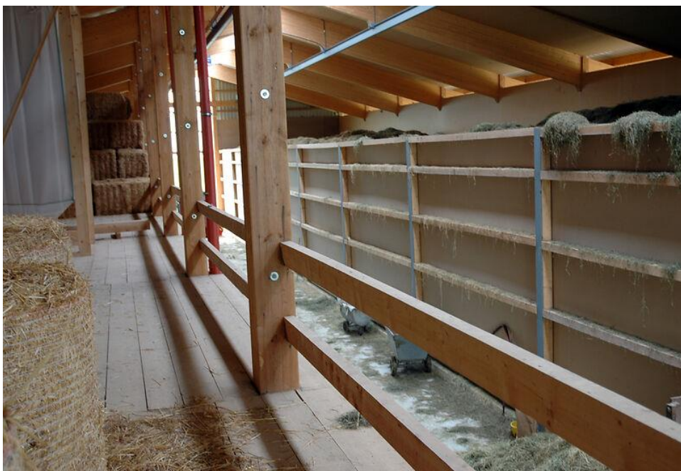
Garde-corps stable sur une plate-forme de stockage avec parapet et barre d'appui
