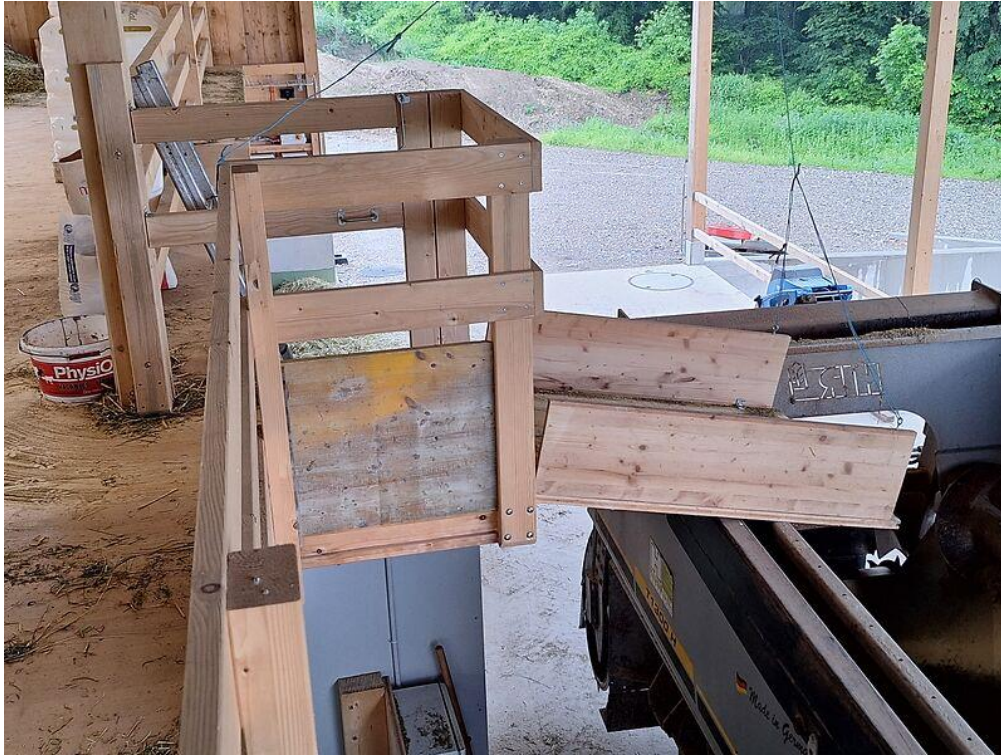
Zone de déversement sécurisée pour le chargement manuel de la mélangeuse d'aliments
