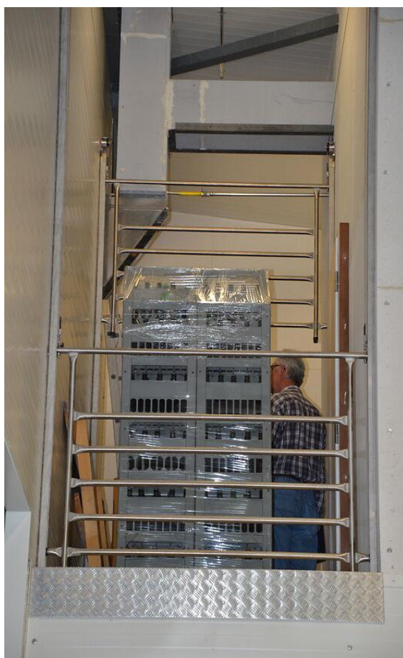
Camera di trasferimento con sistema pendolare
